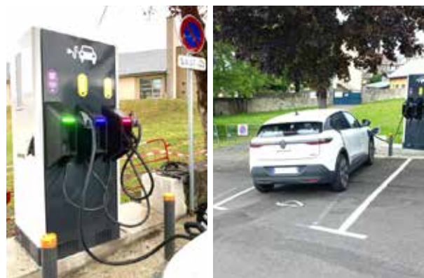
Installation et mise en service d'une borne de recharge pour véhicules électriques parking du 14 juillet (rue du 8 mai)
